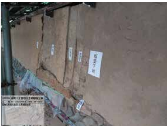
土塀の仕様調査：土壁を少しずつ削り、塗壁の各工程の層を確認
