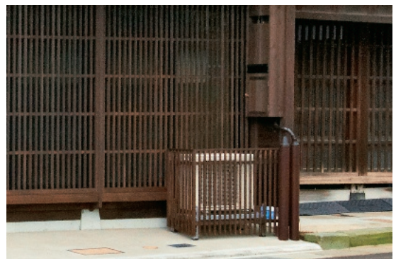
室外機を格子で目隠し
