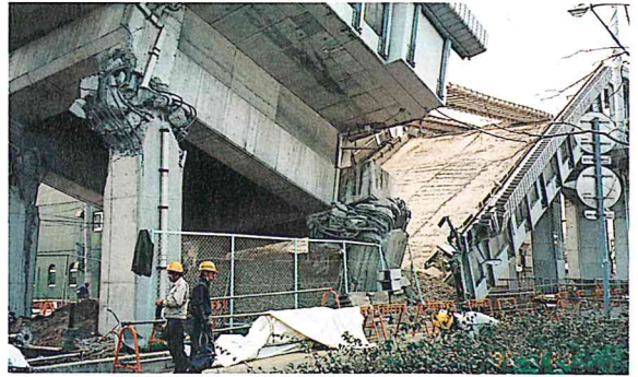
新幹線高架橋の落下(兵庫県南部地震)
