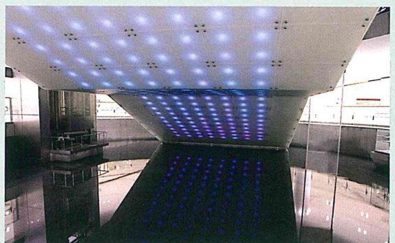
大階段下LED照明
