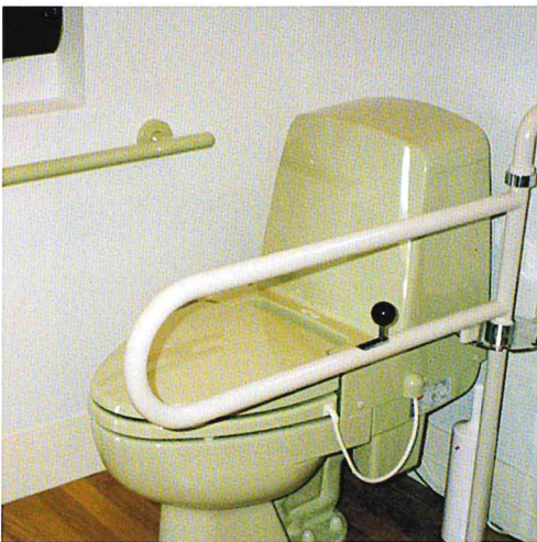
手すりがセットできるように工夫されたトイレ
