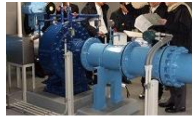
末浄水場に導入されたマイクロ水力発電設備 (年間発電量：約360,000kWh)
