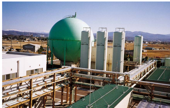
LNGサテライト基地
