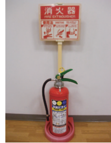
しょうかき 消火器
