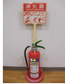
しょうかき 消火器
