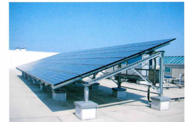
本校屋上の太陽光発電設備
