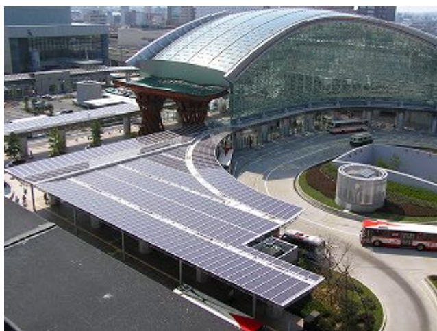
金沢駅東広場 太陽光発電装置
