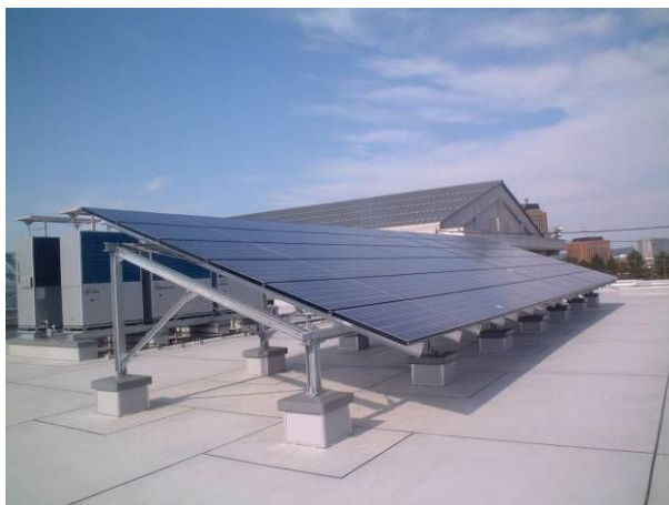
金沢市立工業高等学校の太陽光発電設備 （出力：10kW）
