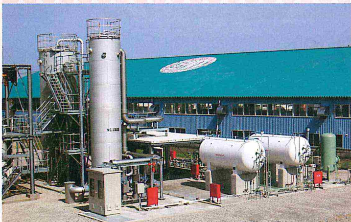
下水道汚泥から消化ガスを精製し都市ガスとして供給しています
